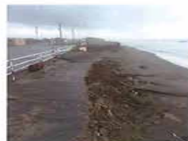
波で海岸の侵食が進んだ中里海水浴場＝千葉県白子町中里の中里海水浴場で、2015年9月18日撮影（千葉県河川整備課提供）
